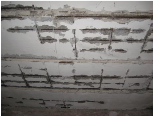
Рис. 2. Відшарування захисного шару бетону збірних залізобетонних плит перекриття
