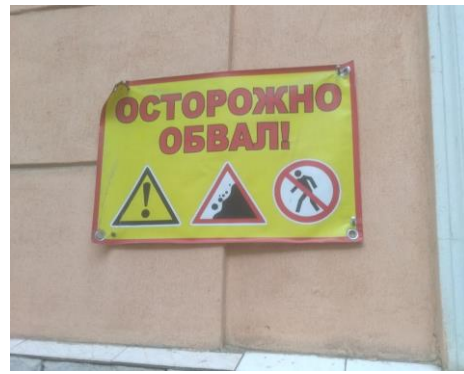
Рис. 3. Попередження на аварійному фасаді будинку
